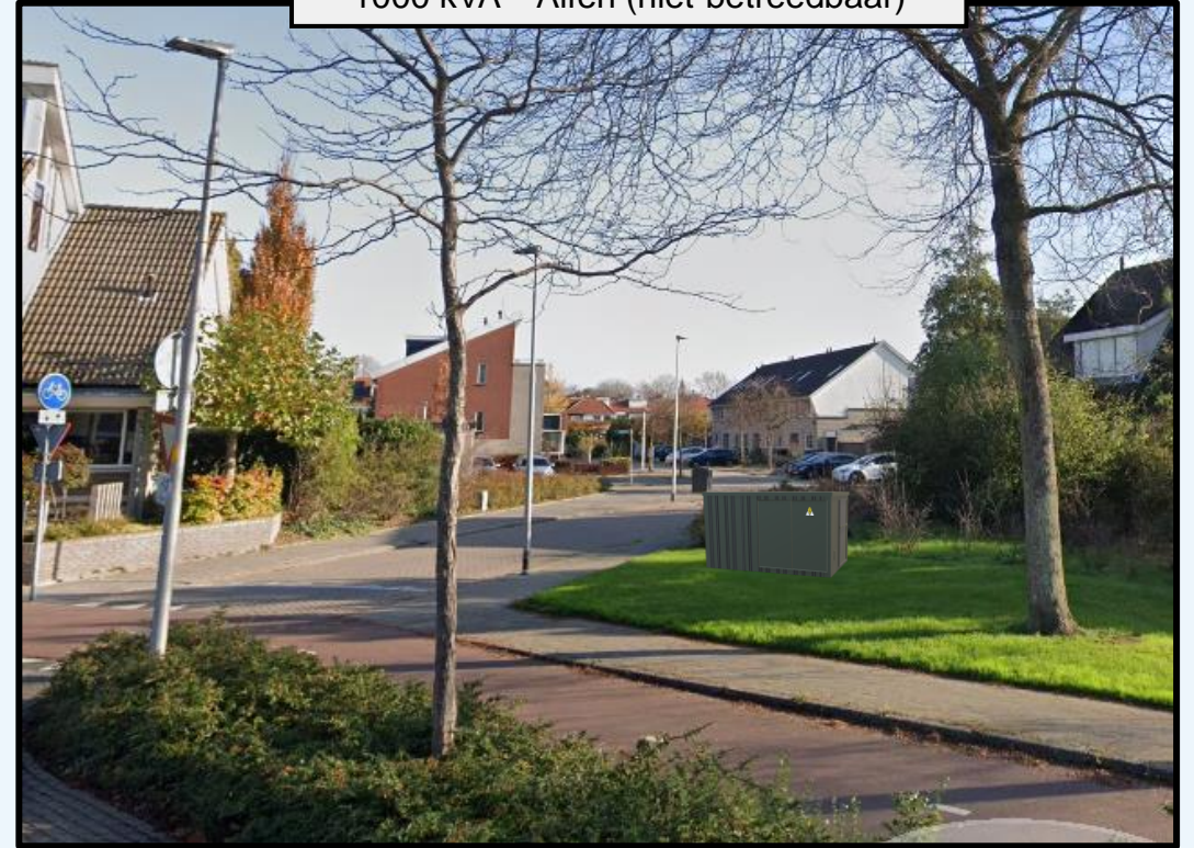
1000 kVA – Alfen (niet-betreedbaar)
